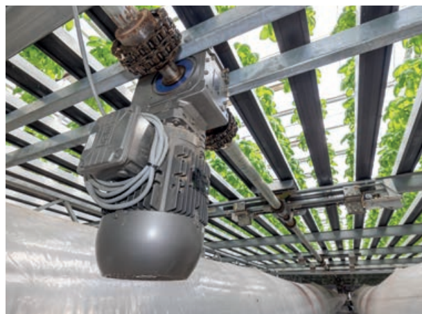
Blik onder de teeltlaag met de luchtslurven in de afkweek. Elektromotoren (met reductoren) drijven een rondsel aan dat de goten middels een tandheugel lineair verplaatst over 200 meter kas.
